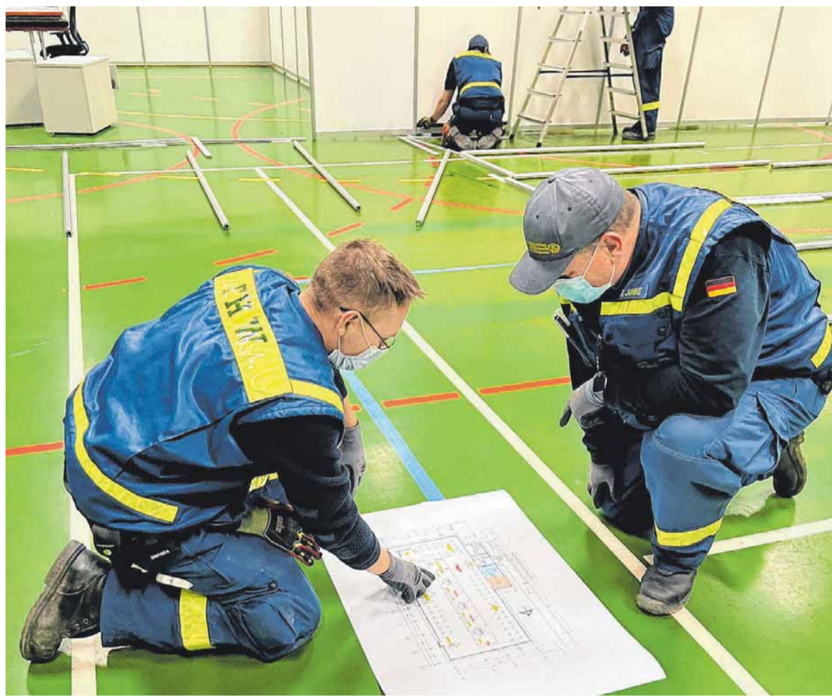
43 Helfer des Technischen Hilfswerks aus den Ortsverbänden Weingarten und Wangen haben schon den Basisaufbau der beiden Impfstützpunkte in der Argonnenhalle in Weingarten und in der Stadthalle in Wangen errichtet. FOTO: THW
